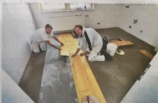
Sebastian Bukowski (li.) und Jason Reyer verlegen Vinyl-Fußboden in den neuen Räumen des Trauerzentrums.
